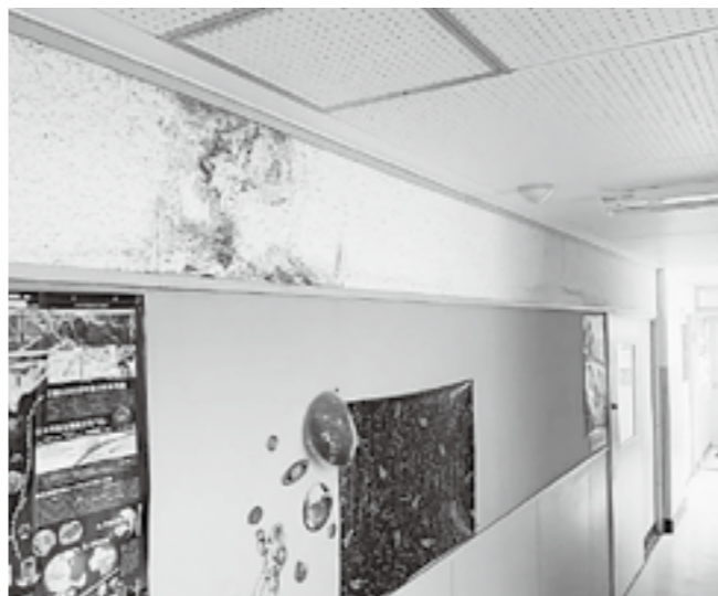
修繕が必要な中学校廊下
