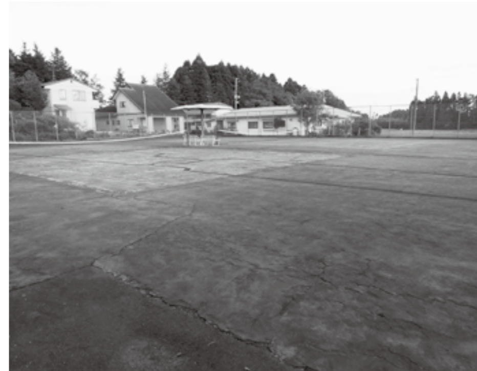
ひび割れの目立つ村民テニスコート
