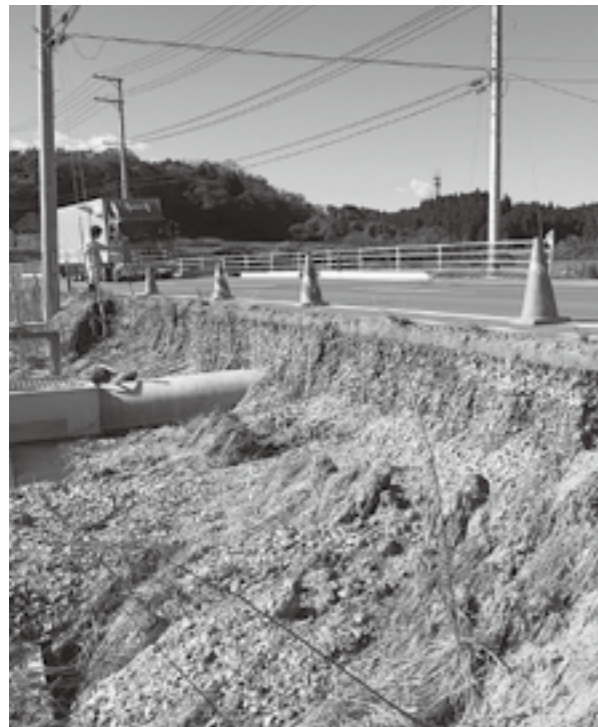
越水により被害を受けた村道（大森地区）
