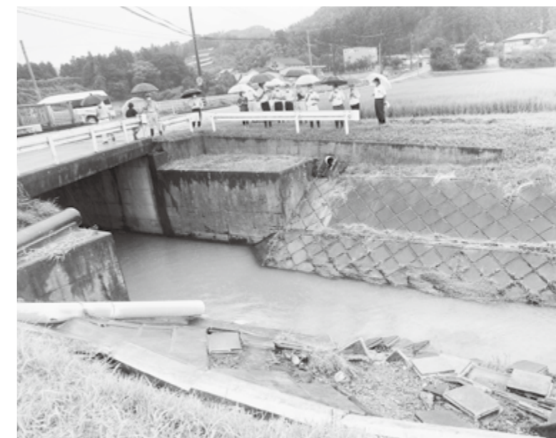
駒場川の被害状況
