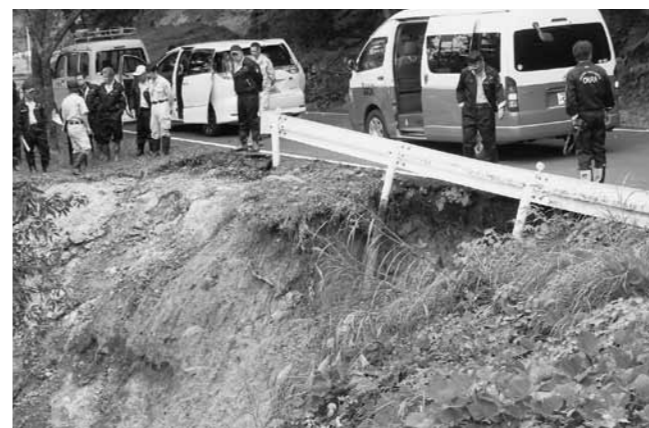
のり面が崩れた牛野ダム線
