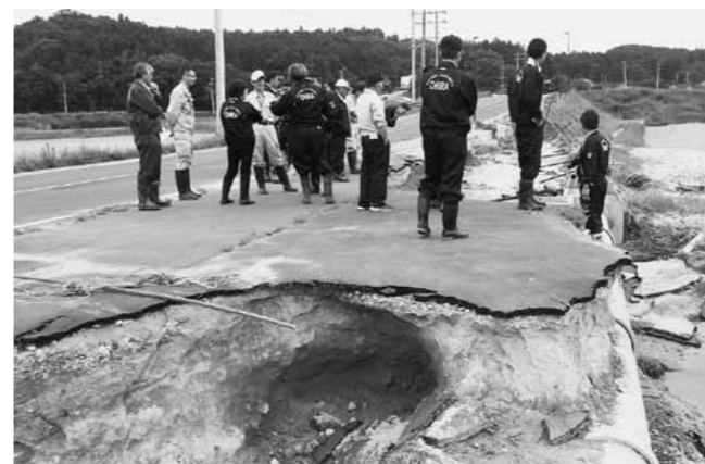
水路・歩道が流された野畑松本線
