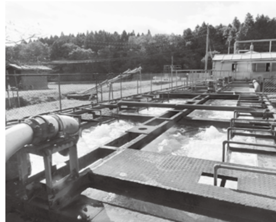
老朽化が進む上北沢排水処理場
