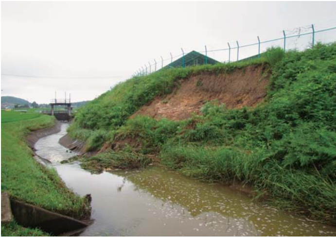
▲駒場地区岩堰地内の法面崩落
